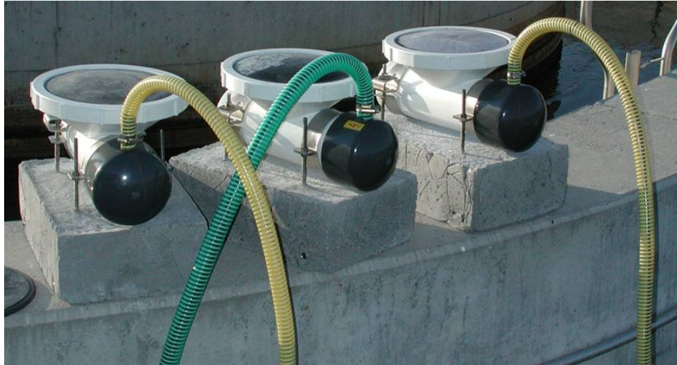
Abbildung 6: Belüfterelemente an Ballastgewichten
